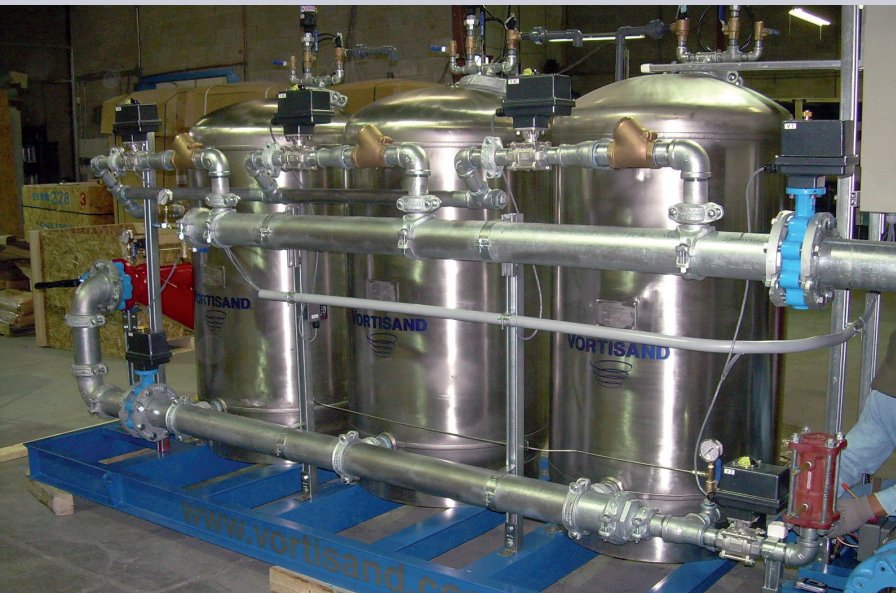
Photo 3 Filtre ultra-fin constitué de trois réservoirs avec un débit dérivé de 68,1 m³/h.
